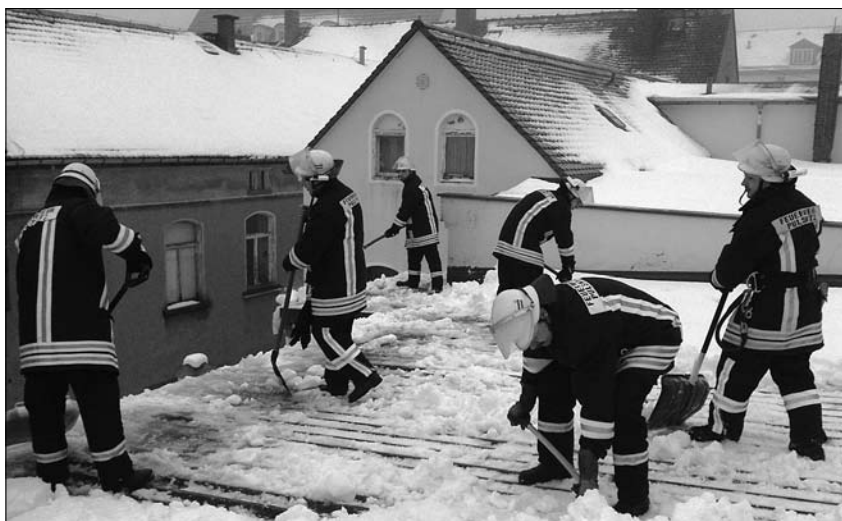
Die Kameraden der Feuerwehr mussten das Dach des Museums räumen, da bereits Schmelzwasser eindrang und innen Schaden verursachte.
