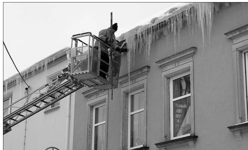
Besonders an den Dächern und Dachrinnen der Ziegenbalgstraße wuchsen die Eiszapfen besonders in die Länge. An der Ecke zum Rathenauplatz gab es Exemplare von über 150 cm Länge. Diese entfernten Lutz Freudenberg und Wehrleiter Steffen Mütze sorgsam von der Drehleiter aus.
