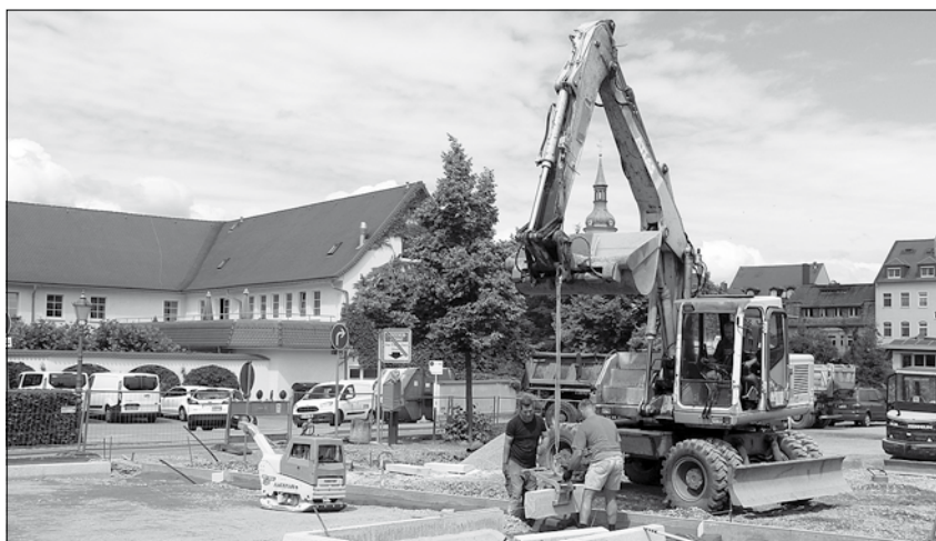
Auf der Wittgensteiner Straße entstand von Juni bis August aus einem Hartplatz ein neu befestigter Parkplatz für Besucher der Klinik und der Stadt. Die 40 neuen kostenpflichtigen Parkplätze werden rege genutzt.
